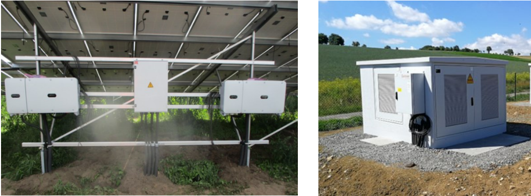
Abbildung 16: String-Wechselrichter und Trafostation (Bildquelle: bejulo GmbH)
